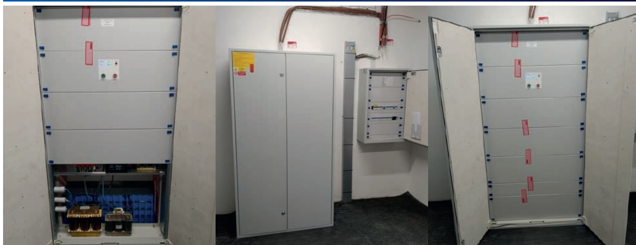
Zdroj: ASTIP STRONG 240kVA/30kVA/3F - 45 min. EI45. Akce: Sportovní hala Topolčany, napájení ventilátorů, klapek
